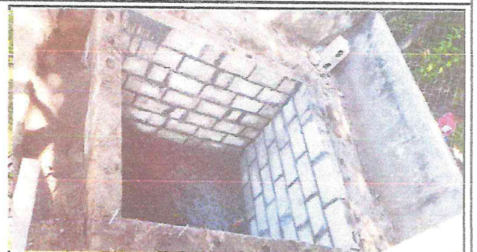
Foto 8: fosa para baños
